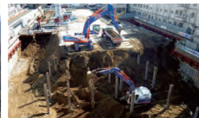
「土工事(どこうじ)」と呼ばれる、ビルやマンションを建てる前に行う地盤の工事も行っています。
